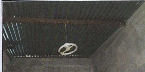
Foto 6: Se deberá corregir realizando nuevas instalaciones eléctricas en la cocina, tanto de iluminación como de tomacorrientes.
