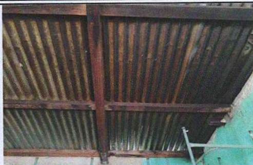
Foto 1: La lámina del área de la cocina tiene lamina que está picada y la estructura es de madera que ya se encuentra en mal estado, por lo que se requiere cambio a estructura de metal y lamina troquelada
