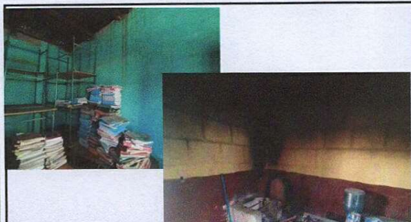
Foto 3: Las paredes se han cubierto de hollín por lo que requiere una limpieza profunda, y pintura sobre el cernido aplicado
