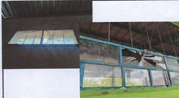
Foto 2: Las ventanas se encuentran deterioradas y obsoletas, por lo que se requiere cambio de ventanas a tipo paleta para aprovechar la ventilación mas balcón para la seguridad.
